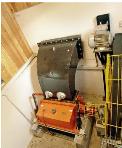
OSSBERGER®-Durchströmturbine in der Neumühle (Quelle: Markt Mühlhausen)
